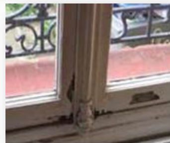
Humidité - étanchéité boiserie
